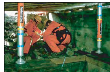
Colapso de edificaciones
